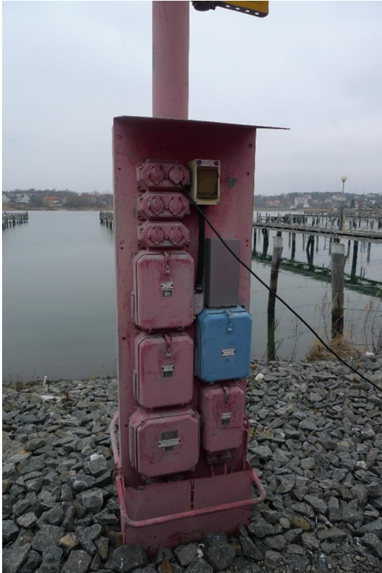
Figur 10. Elcentral vid Hinsholmskilen.
