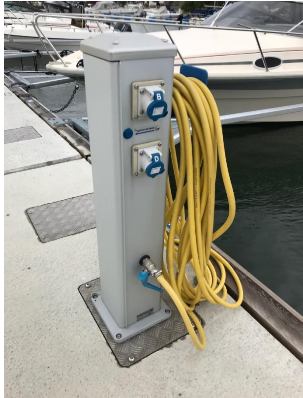
Figur 11. El- och vattenstolpe på flytbrygga vid Saltholmen.
